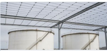
Резервуарные парки 储油罐区大跨度网罩 Купольное перекрытие над дыхательными клапанами.
