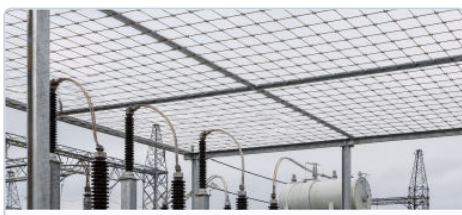
Подстанции/ ТЭС 变电站主变压器防护 Шатровое покрытие над трансформаторами и КРУЭ.
