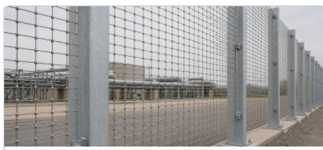
Периметр объекта 厂区周界立式网墙 Высокий вертикальный барьер от брейющих FPV.
